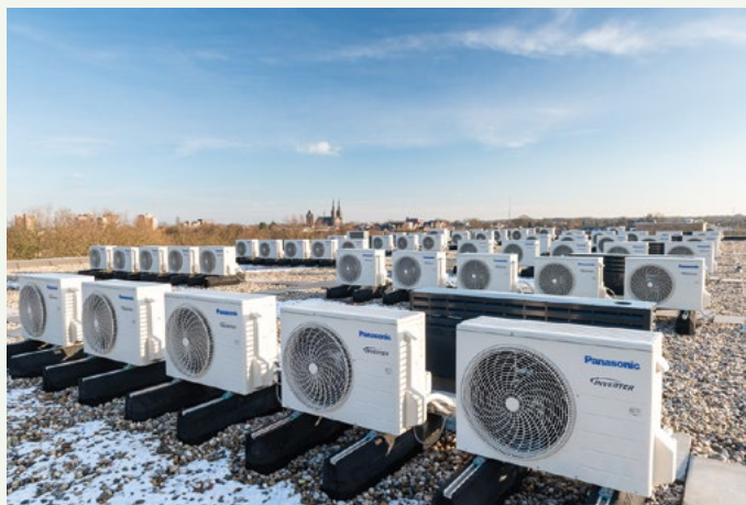
75 Warmtepompen appartementen Cuijk. Aquarea All in One
